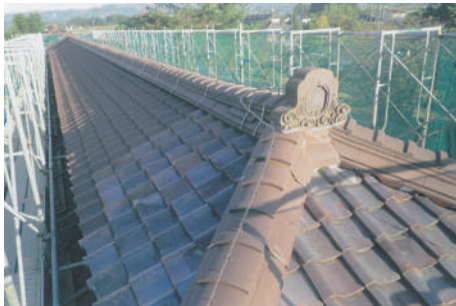
写真 4-5 棟上導体方式避雷設備（蚕室）
