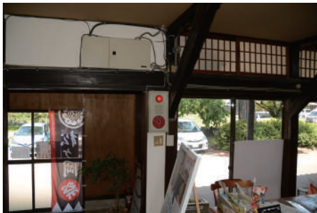
写真 4-4 自動火災報知設備
