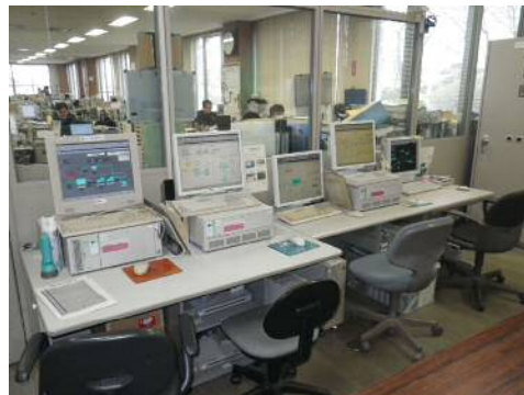
水道施設監視システム
