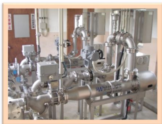
五十川水源地【紫外線照射装置】
