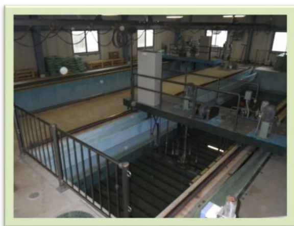
温海浄配水場【急速ろ過設備】
