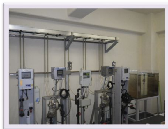
温海浄配水場【水質計器】
