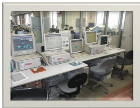
水道施設監視装置
