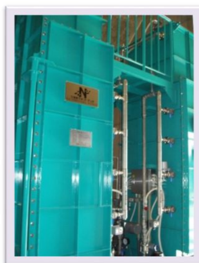
温海川浄水場【膜ろ過装置】
