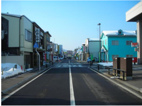
山王商店街みち空間再生事業 (歩道拡幅・無散水融雪・無電柱化)
